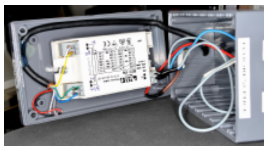
Fig. 27 - b): Alimentatore per tubo fluorescente; interno: si nota il ballast con i relativi collegamenti alla lampada, all'interruttore e alla rete.
